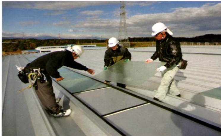
割れたガラスとその復旧
