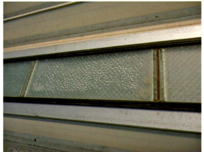
ガスケットの劣化で 嵌合部から雨水が侵入しガラス裏面に結露したもの
